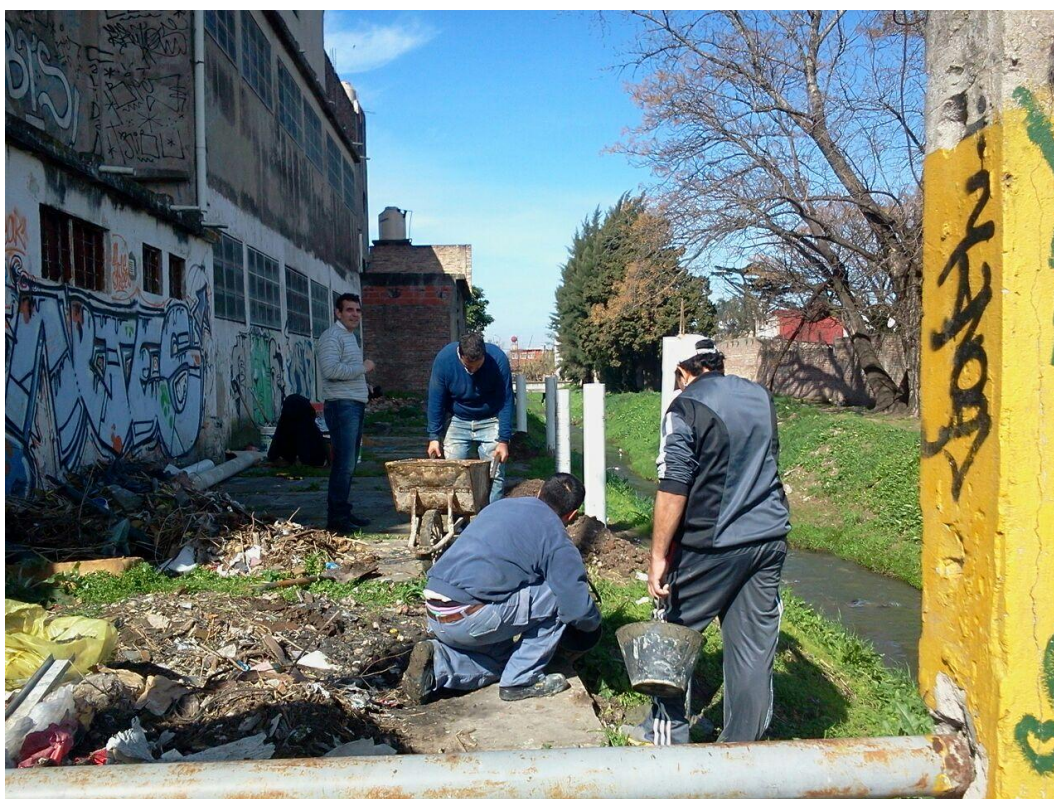
Trabajo de docentes y auxiliares en la construcción de barandas a orillas del arroyo.
