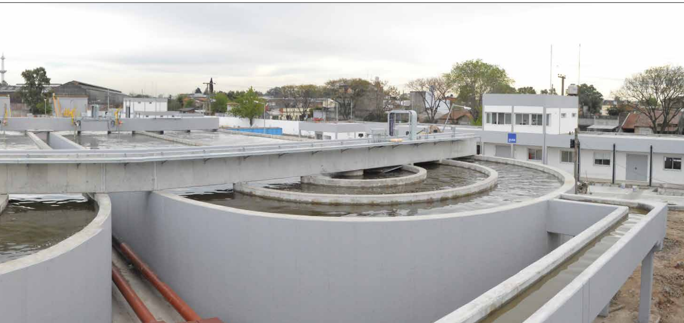
Vista panorámica de los reactores de la planta.
