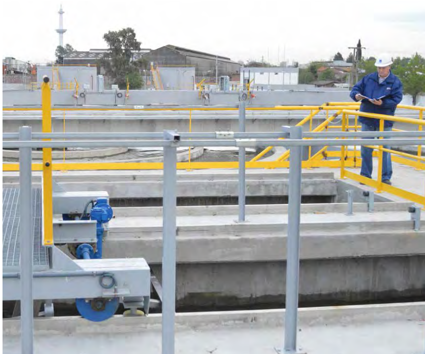
La planta cuenta con 4 reactores y una capacidad de 23.000m 3 /días.
