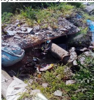
Foto 1. Zanjas con basura y escombros; zona entre Camino de Cintura, Santa Magdalena, arroyo Santa Catalina y San Martín
