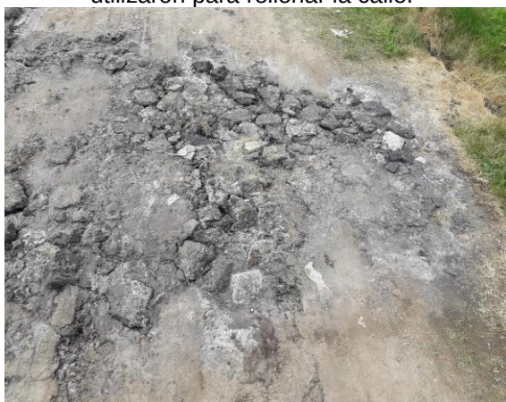
Foto 1. Restos de fundición, los cuales se utilizaron para rellenar la calle.
