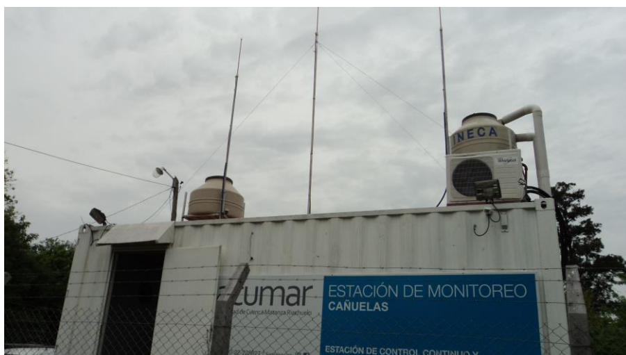
Figura 1.13 Estación de Monitoreo y Control Continuo Cañuelas.
