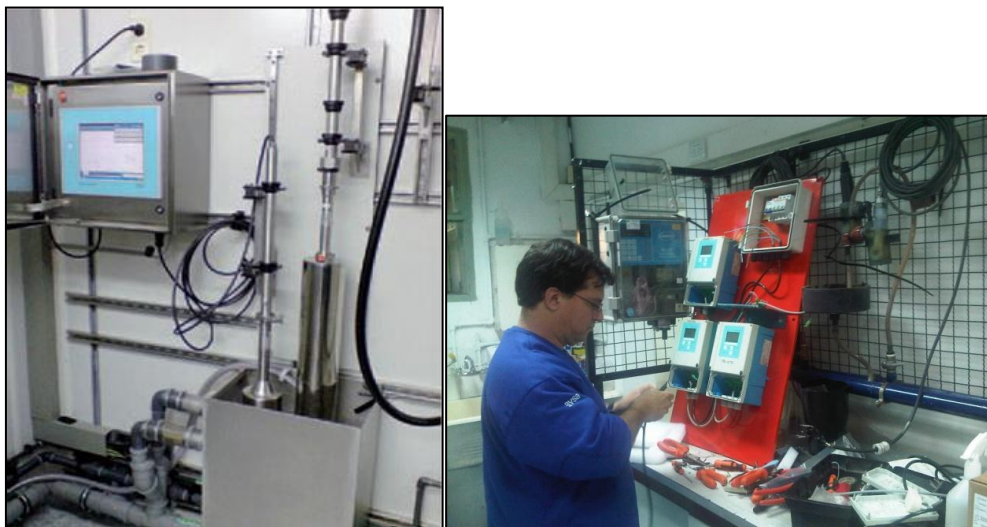
Figura 1.4. Estación Piloto de Control de Caudal y Calidad del Agua Continuo y Automático, Club Regatas Avellaneda: ubicación y vista de la estructura contenedora y de parte del instrumental a utilizar.
