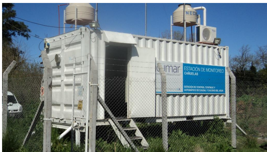
Figura 1.7 Estación de Monitoreo y Control Continuo Cañuelas.
