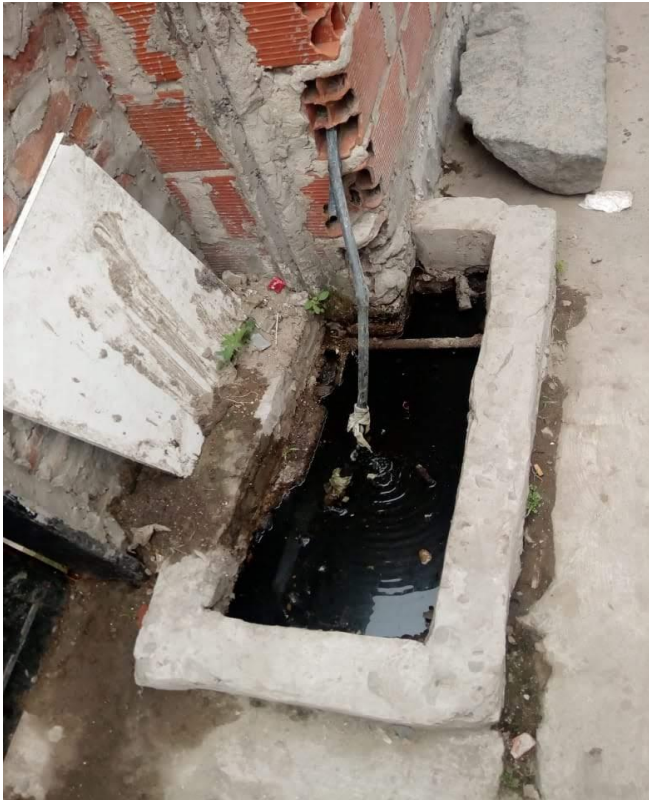
Desagües abiertos en un pasillo de Tellier
