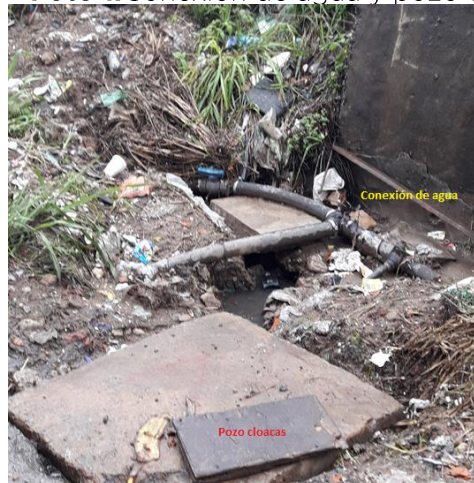
Foto 1. Conexión de agua y pozo cloacal
